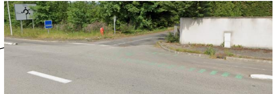
Marquage effacé aux abords des intersections de la piste cyclable.
